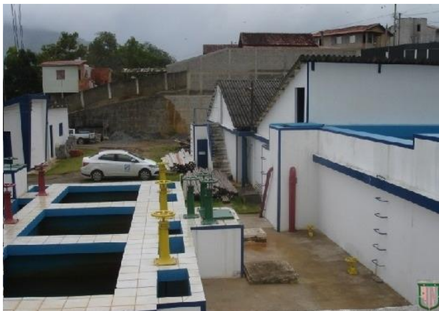
Figura 37 – Registro das instalações de tratamento de água
