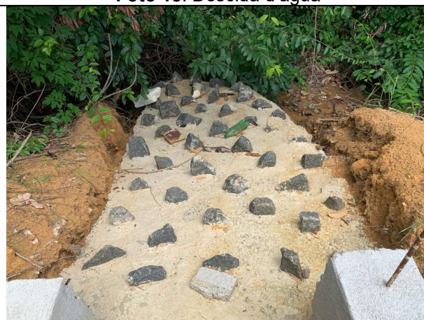
Foto 18: Dissipador de energia
