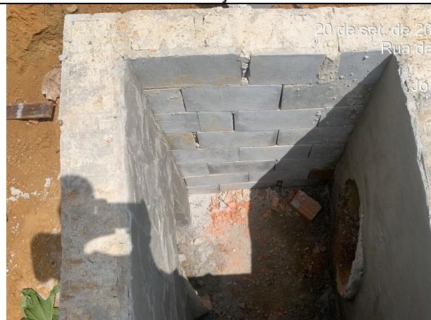
Foto 11: Poço de Visita
