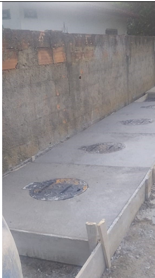
Foto 18: Tampas dos Poços de visitas
