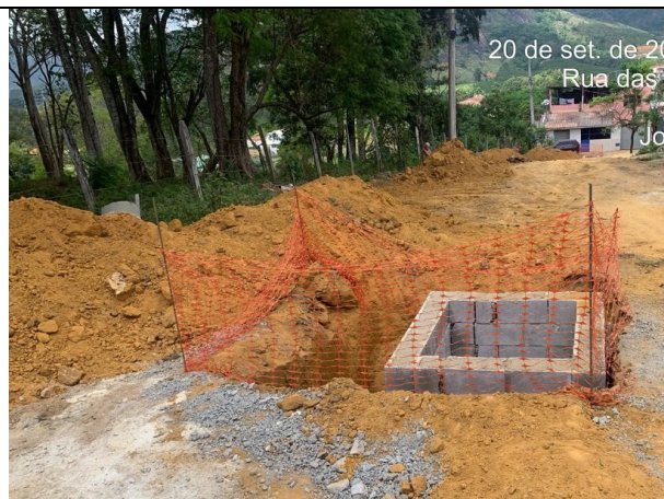
Foto 08: Poço de Visita
