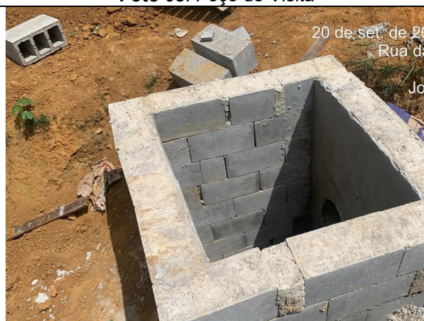
Foto 10: Poço de Visita
