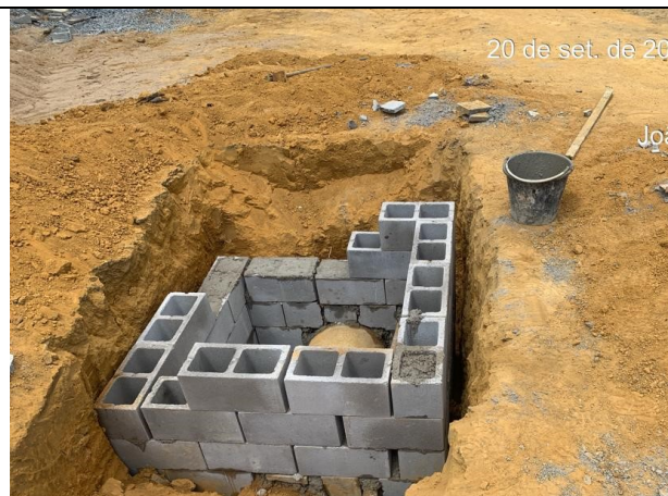
Foto 07: Poço de Visita
