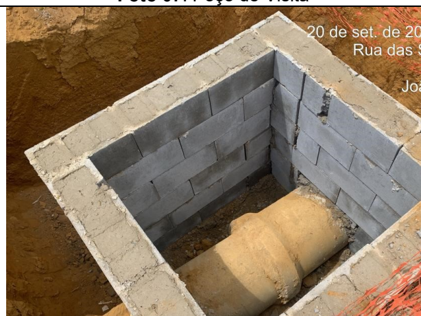
Foto 09: Poço de Visita
