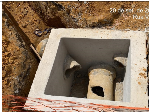
Foto 12: Poço de Visita
