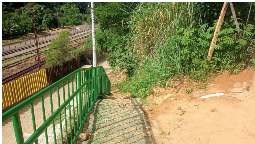
Foto 01: guarda-corpo acima do muro
