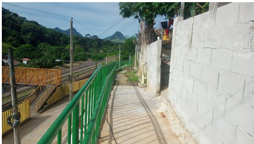
Foto 02: guarda-corpo acima do muro
