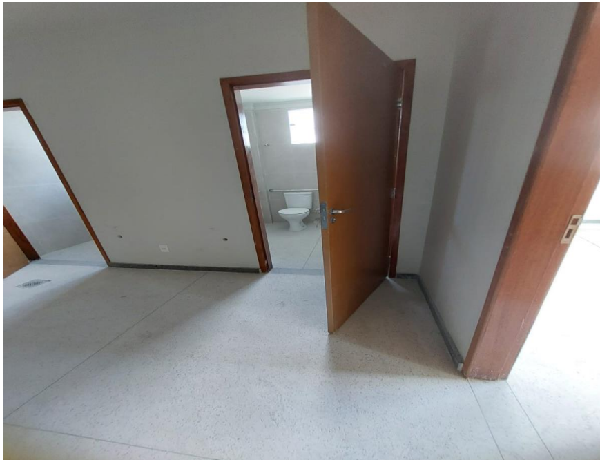
Foto 11: portas e pintura
