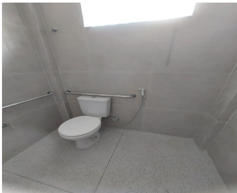
Foto 08: louças e barra de apoio
