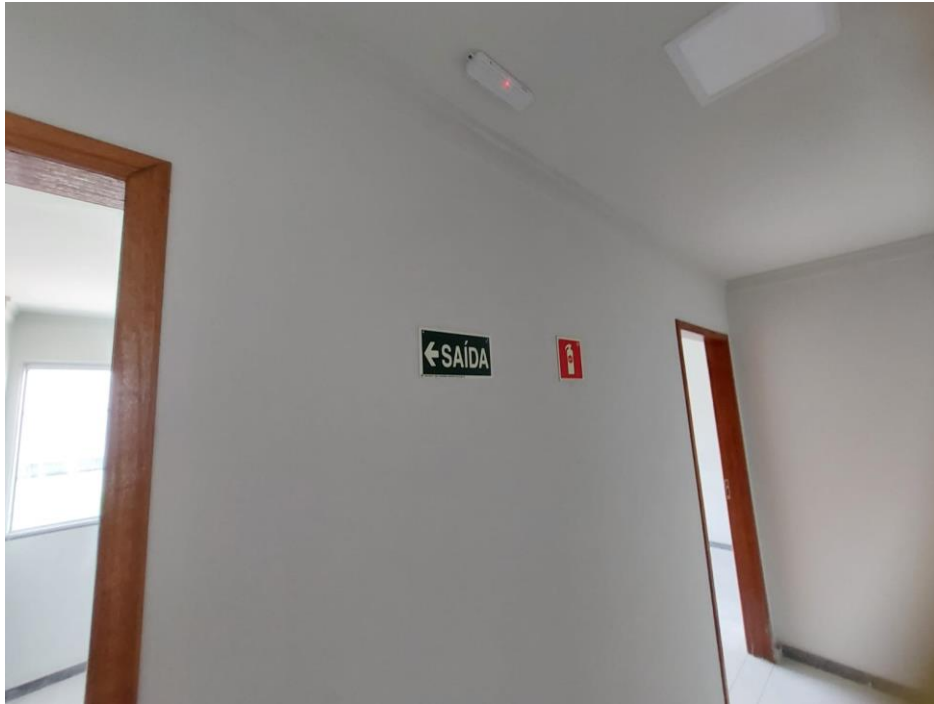
Foto 14: placa de sinalização
